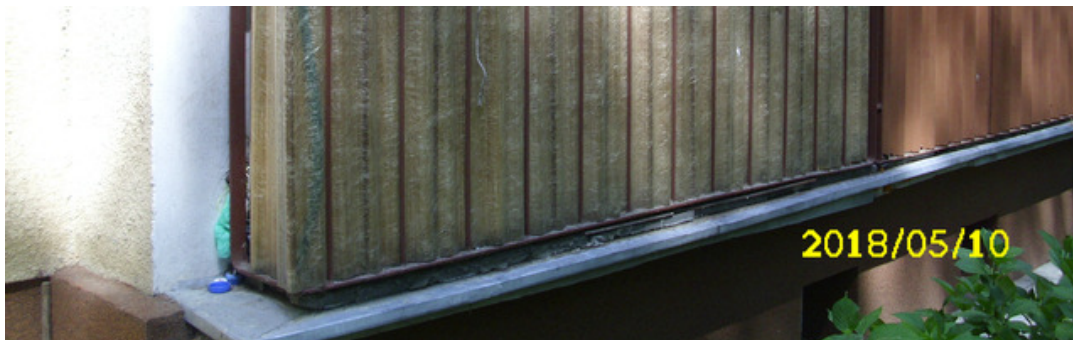
Fot. 3: Uszkodzenie warstw wykończeniowych przy krawędzi płyty,
