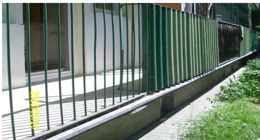
Fot. 3: Uszkodzenie warstw wykończeniowych przy krawędzi płyty,
