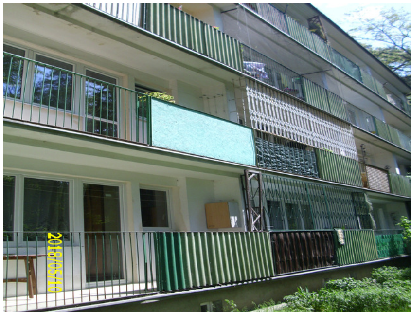
Fot. 2: Stan istniejący – Wypełnienie balustrad płytami z azbestu
