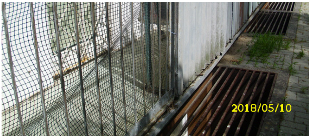
Fot. 3: Uszkodzenie warstw wykończeniowych przy krawędzi płyty,
